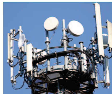
■ Abb. 4: Radaranlagen und Antennen ermöglichen die Überwachung des Mobilfunkverkehrs (sst).
