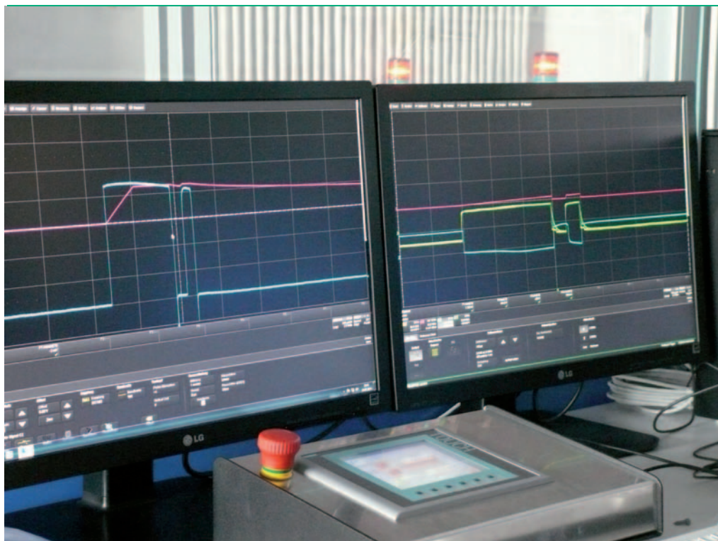
Abb 4: Steuerstand eines Testgerätes für Hochleistungshalbleiter am Zentrum für Energietechnik (ZET).
